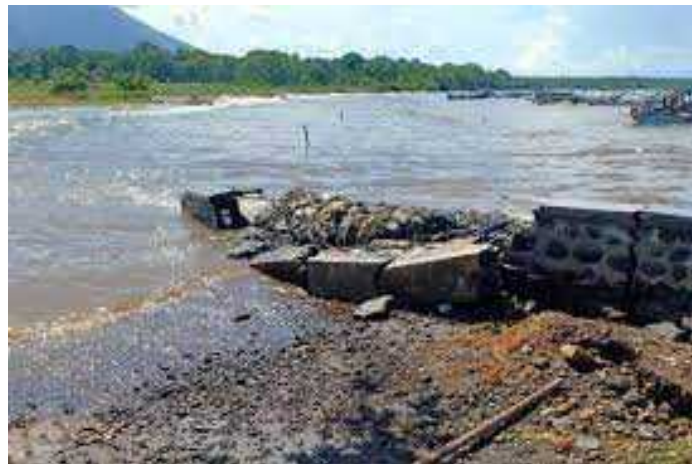
Gambar 1. Kerusakan Bangunan Tanggul Laut ( Sea dikes )
