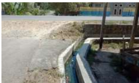
Gambar 2. Saluran Drainase yang tersumbat di Desa Mopaano
